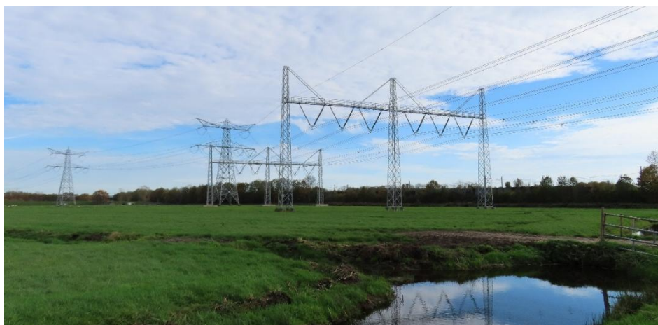
Figuur 3.4. Portaalmastconstructie waarin de hoogspanningsdraden laag gespannen zijn (vooraan), zodat aalscholvers en lepelaars veiliger kunnen passeren. Op de achtergrond staan masten met draden op gangbare hoogte.
